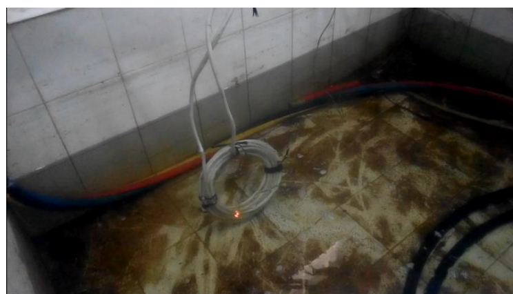
Keadaan Tembus Uji Tegangan Kabel NYM 3 x 2,5 mm 2
