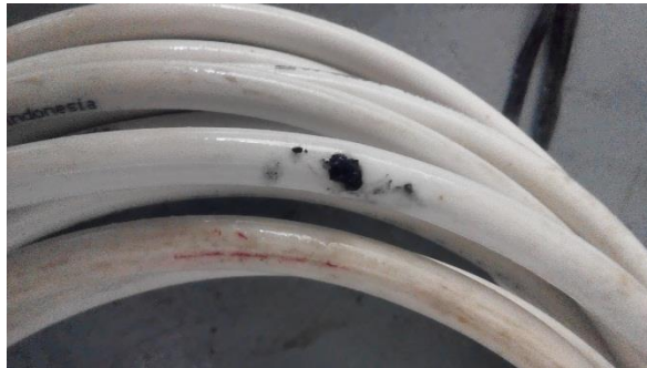
Keadaan Tembus Kabel NYM 3 x 2,5 mm 2
