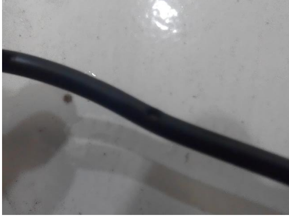
Keadaan Tembus Kabel NYA 1 x 2,5 mm 2
