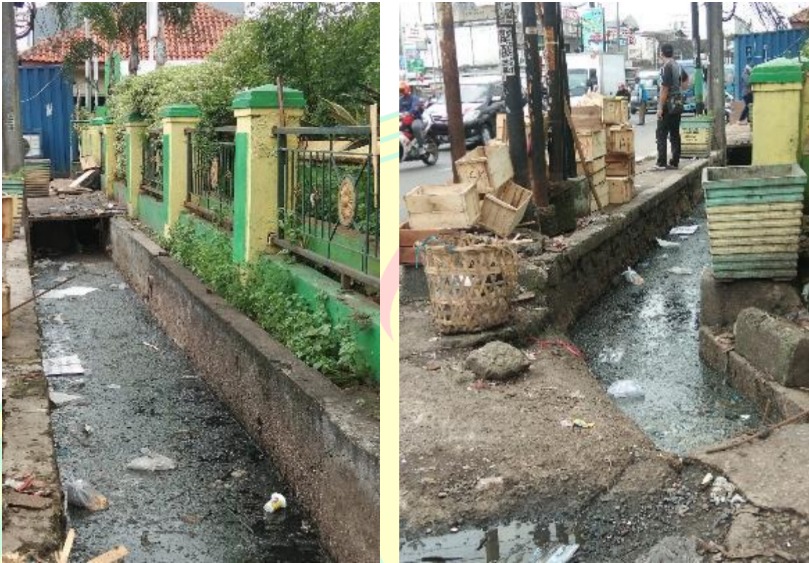
Gambar 8. Drainase Sumber: Dokumentasi Pribadi, 2020
